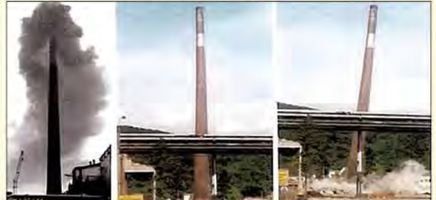
09.09.1995, 11:57 Uhr - ein historischer Moment: Ein dummer Schlag, Mauerteile brechen aus dem südöstlichen Sockelfuß ... der Schornstein neigt sich und legt sich in die vorbereitete Schneise
